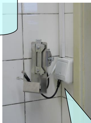
Propojovací kabeláž zakončená v zásuvce s konektorem RJ45.
